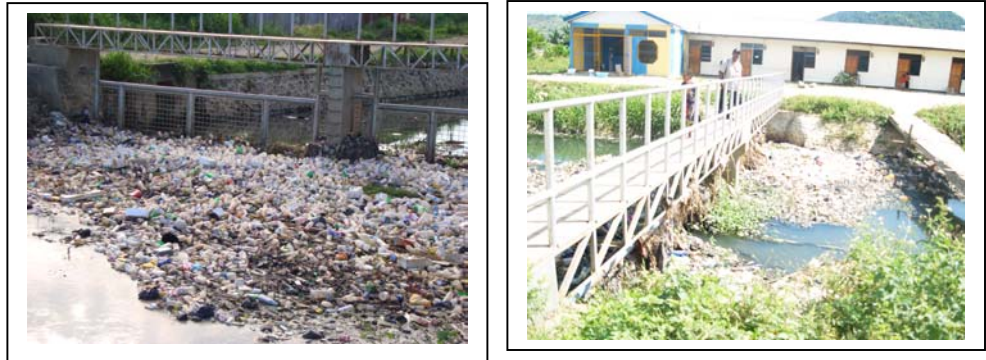
Gambar 3.3. Sampah di sungai dan semakin banyaknya pembangunan pada sempadan sungai.
